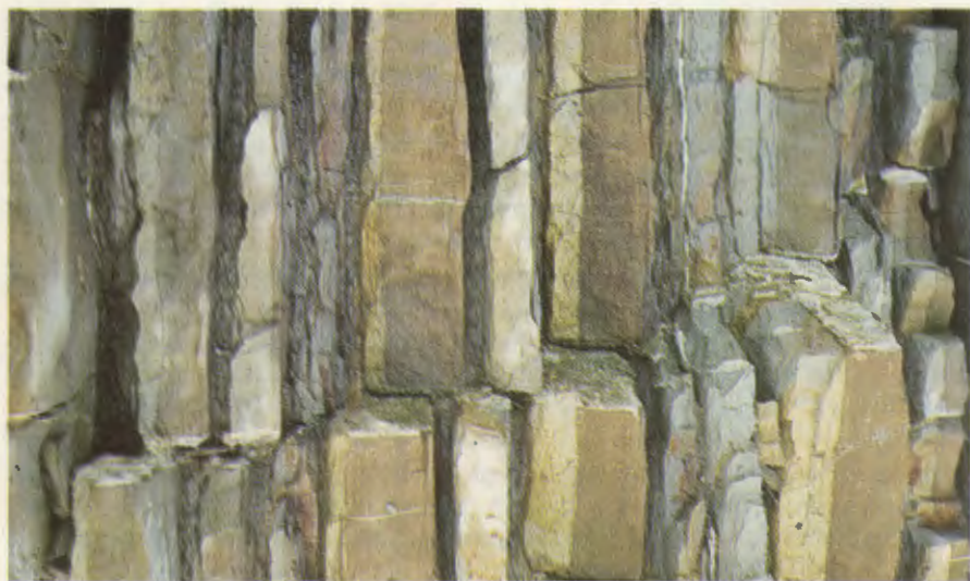
La acción erosiva del mar es muy importante. La alternancia de materiales de distinta resistencia provoca un efecto erosivo diferencial según la dureza de los mismos. En Mompás observamos fallos en estos materiales.
