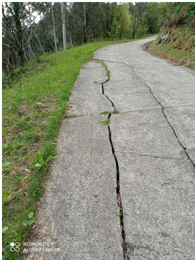
Hormigoizko pista, egoera txarrean.
