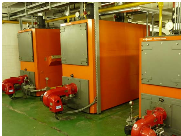
Figura 15.- Equipos de generador de calor del sistema de distrito Fuente: CENER
