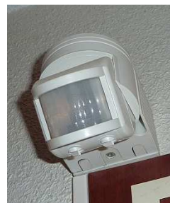
Sistema de control de bajo coste instalado en el portal 25
