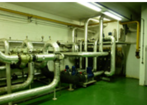
Instalakuntzak eta galdara gela. Bidebieta I
