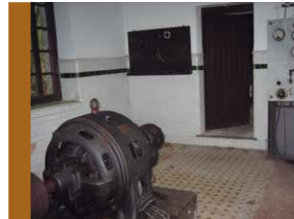
Generador de la central. Autor: Margi Iturriza
