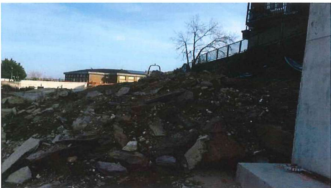
Material aportado a modo de pasivo en el talud excavado entre los muros y el recinto vallado
