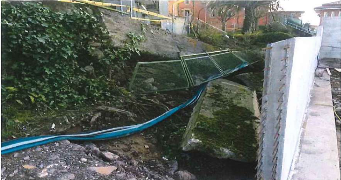
Material deslizado en el trasdós de los nuevos muros
