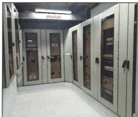
Cuarto eléctrico principal, corte eléctrico
