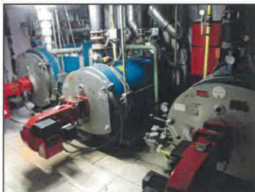
Sala de calderas
