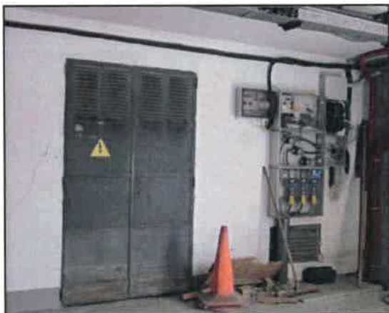
Entrada a sala eléctrica
