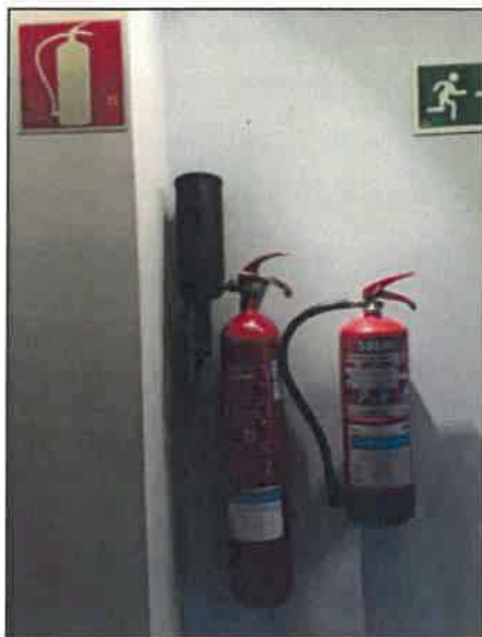
Ejemplo de extintor CO 2 y extintor Polvo ABC
