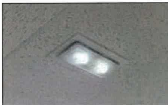
Alumbrado de emergencia
