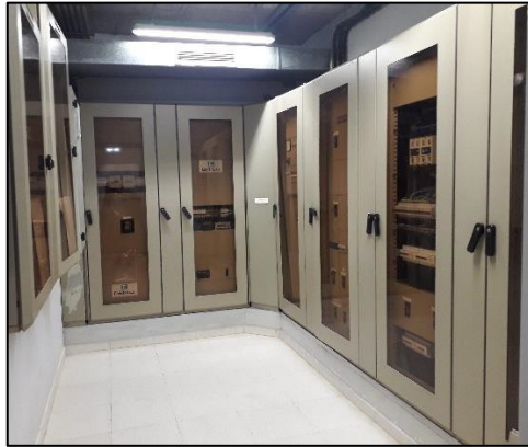
Gela elektriko nagusia (argindarra kentzea)
